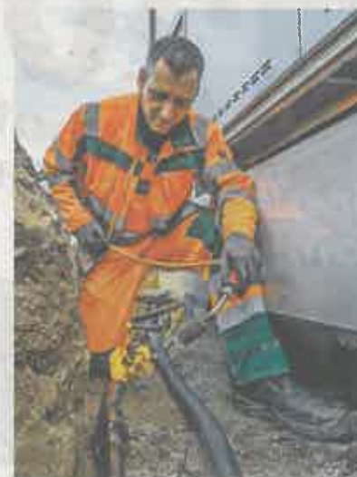
Der Elektriker Udo Ertel von der Humuswirtschaft Kaditz GmbH bereitet mit vielen anderen Kollegen die neuen Schaltanlagen vor, damit die Telekom die Technik einbauen und in
